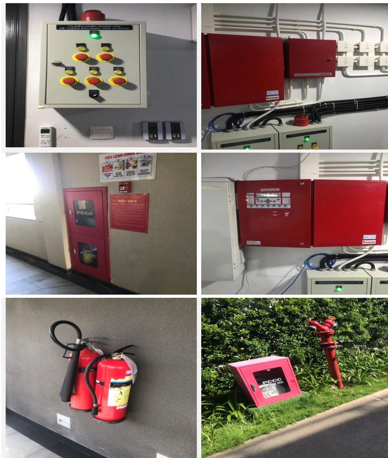
Hình 3.7 Hệ thống phòng cháy và chữa cháy được lắp đặt tại Dự án
